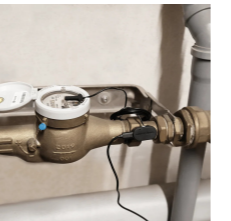
wasserleser.reed am Wasserzähler installiert
